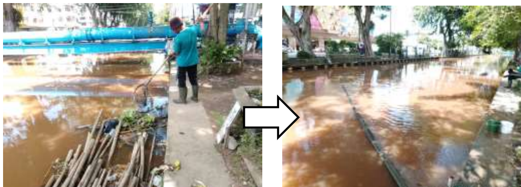
Gambar 3. 12 Kondisi Saluran Drainase Sebelum Pemeliharaan dan Setelah Pemeliharaan
